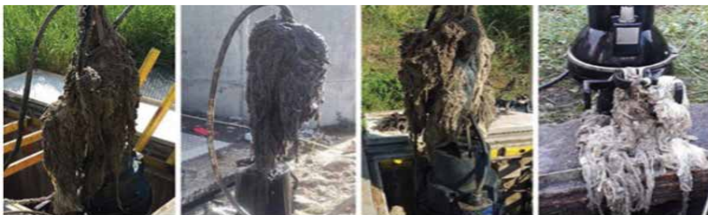
Exemples d'accumulation de lingettes autour des pompes
